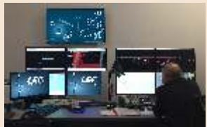
Sistema di supervisione SCADA Il sistema di controllo e monitoraggio LEF all'interno di una sala movimento che controlla gli Armadi di Piazzale (ADP) e l'illuminazione
